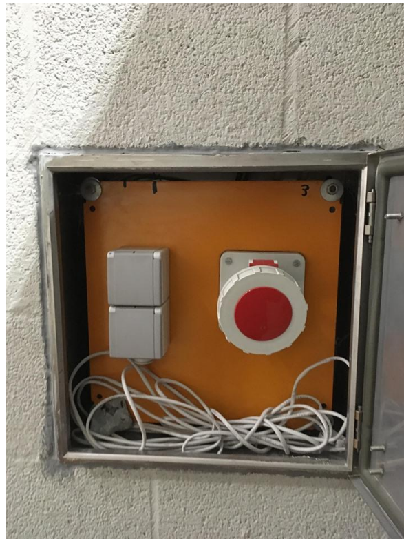
In de 4 inhammen van de tribune is er telkens een kast met 63A aansluiting + 2 stopcontacten.
