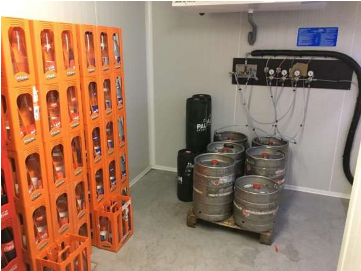
Koelcel (aansluiting tapinstallatie)
